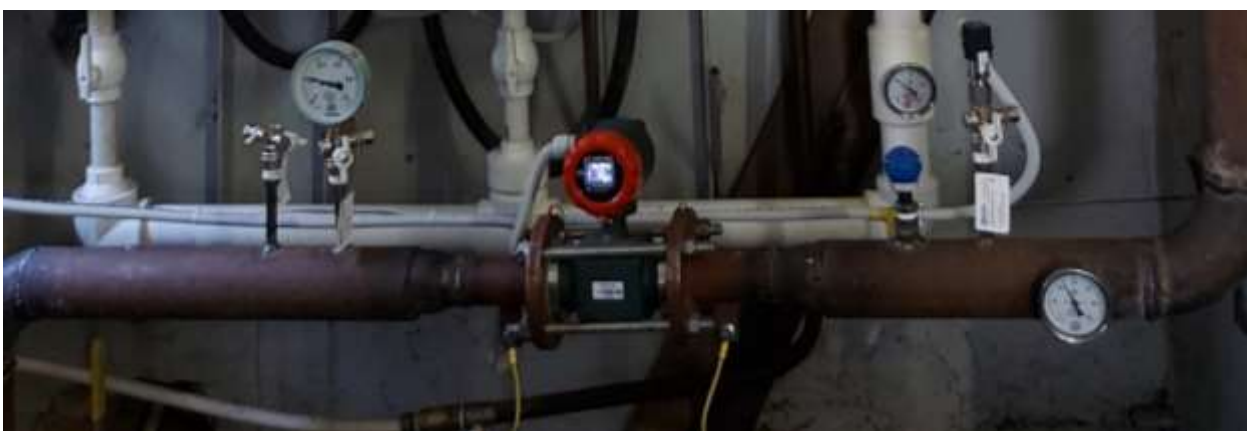
Рисунок 1.6 Внешний вид узла учета подающего трубопровода тепловой энергии, установленного на котельной ГЛОХ
