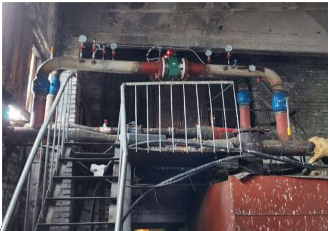
Рисунок 1.4 Внешний вид узла учета подающего и обратного трубопроводов тепловой энергии, установленных на котельной пос. Запорожское
