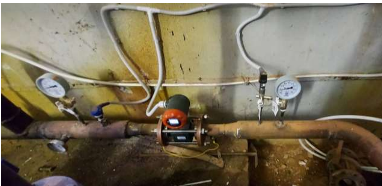
Рисунок 1.7 Внешний вид узла учета обратного трубопровода тепловой энергии, установленного на котельной ГЛОХ
