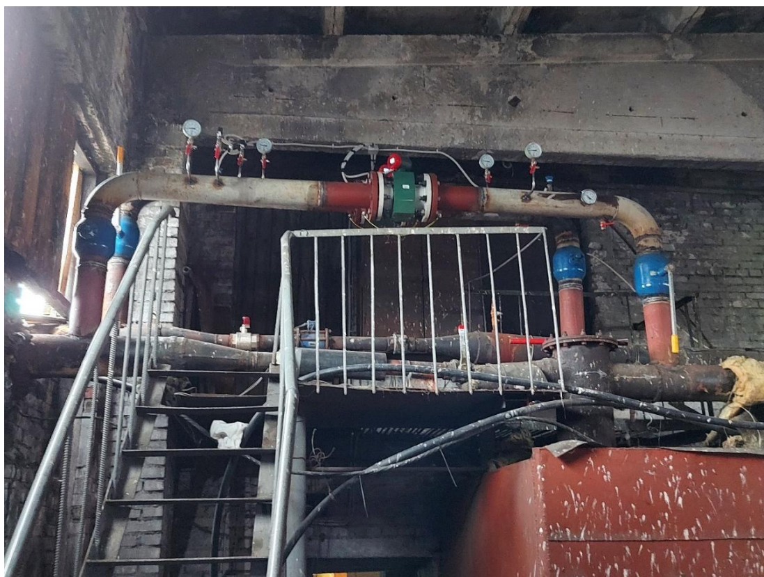
Рисунок 6. Внешний вид узла учета подающего и обратного трубопроводов тепловой энергии, установленных на котельной п. Запорожское
