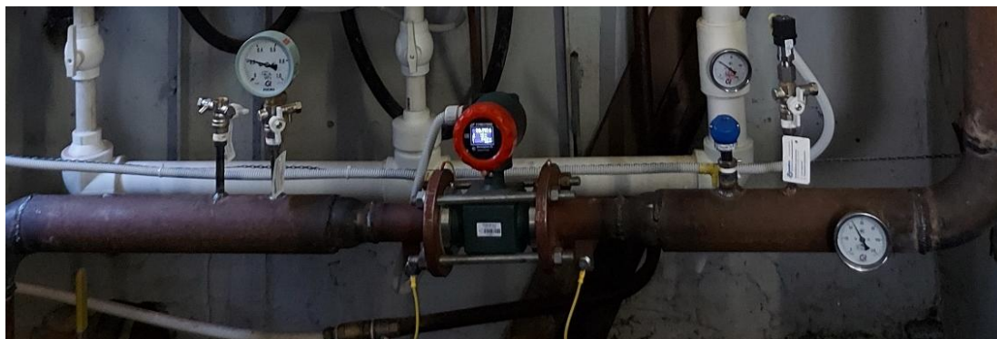
Рисунок 7 Внешний вид узла учета подающего трубопровода тепловой энергии, установленного на котельной ГЛОХ
